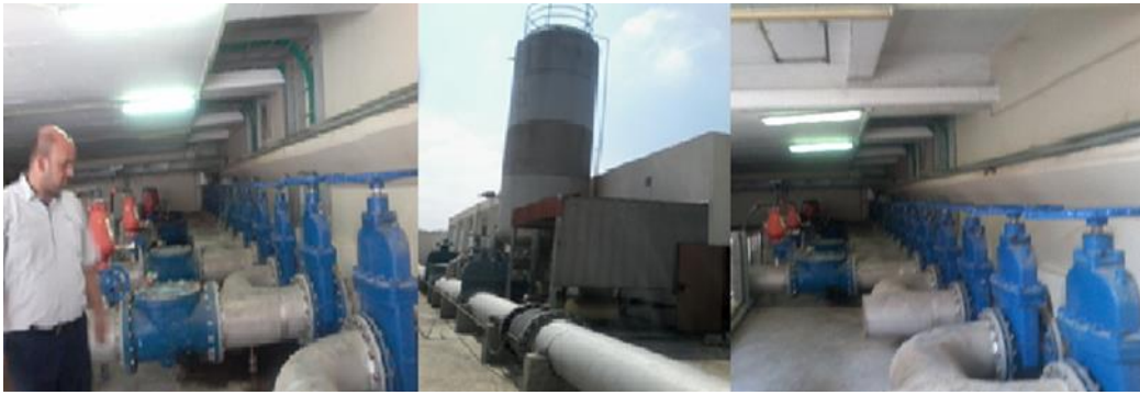
شكل(5) مضخات ضخ المياه إلى محطة المعالجة شرق غزة. إعداد الباحثين.
